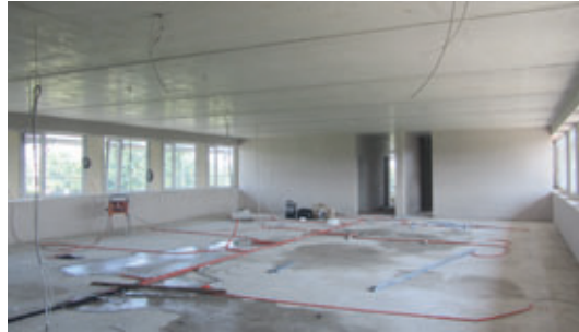
Flachdecke als ideale Fläche für den Wärmeübertrag zwischen Raum und Decke
