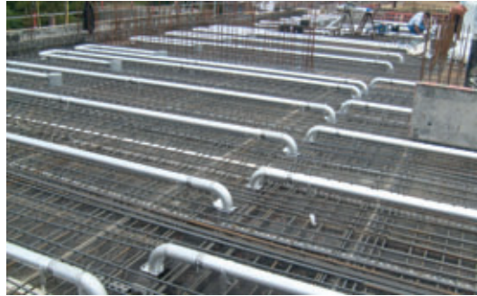
Anordnung der Lüftungsleitungen im Grundriss der bewehrten Rohbaudecke (Copyright Kiefer Luft und Klimatechnik GmbH, Stuttgart)
