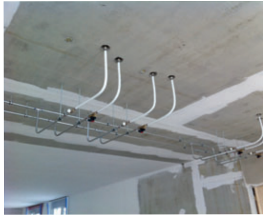
Anschluss der Rohrregister an die Hauptversorgungsleitungen unterhalb der Deckenkonstruktion
