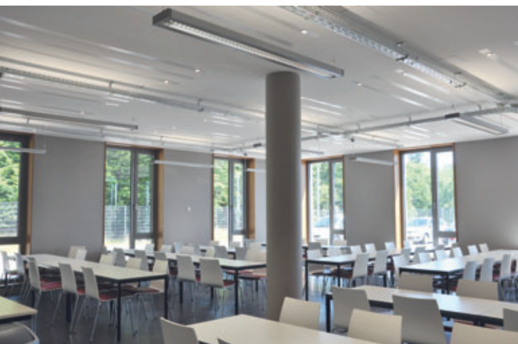
Deckenoberfläche einer tragenden Betondecke mit der Funktion einer Kühldecke
